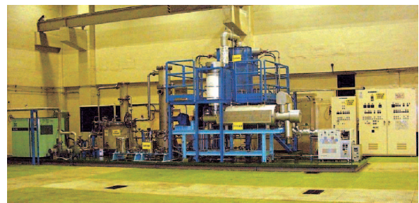
写真1 移設後の水蒸気改質処理試験装置
