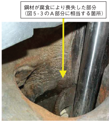
図5-2 PWSCCによる原子炉圧力容器上蓋(図5-3のA部分に相当する箇所)の損傷状況 米国の原子力発電所データベースにおいて2002年に見つかったPWSCCによる原子炉圧力容器上蓋の損傷の写真です。この事例では、原子炉圧力容器上蓋の鋼材がPWSCCによって漏れ出した1次冷却水中のホウ酸が長期間にわたって湿った状態で存在したために鋼材の腐食が起こって写真のような穴が開いてしまいました(厚さ約17cmの上蓋鋼材は完全に腐食していました)。辛うじて上蓋の内側に貼られていた厚さ約1cmの内張り材により大事故にならずに済みました。
