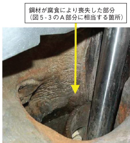
図 5-2 PWSCCによる原子炉压力容器上蓋(図 5-3 の A 部分に相当する箇所)の損傷状況
