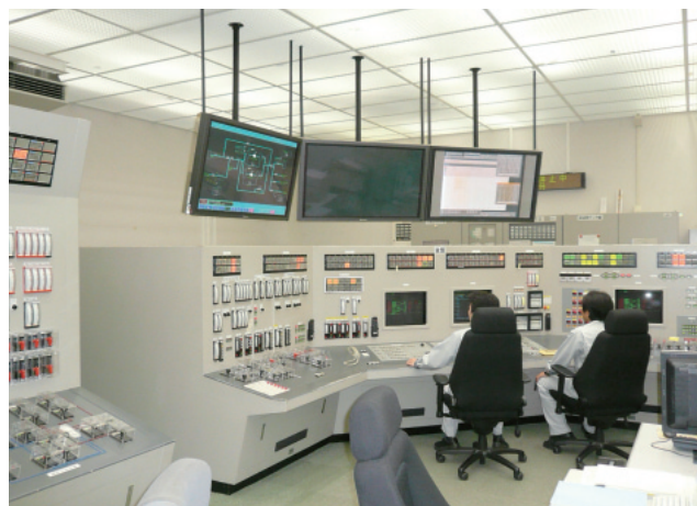
HTTRの中央制御室
