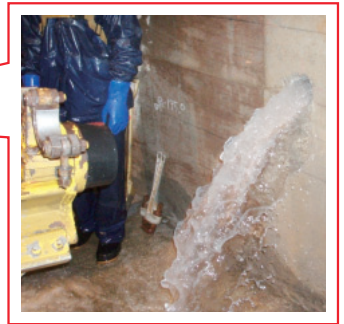
図14-25 プレグラウチングの注入孔からの湧水 プレグラウチング注入孔を掘削した時に発生した湧水（湧水量は毎分約500ℓ）です。
