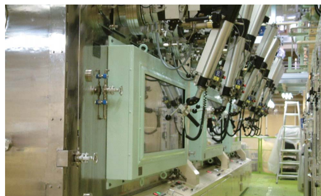
図8-3 NUCCEF施設に設置したTRU高温化学モジュール放射能の高い超ウラン元素（TRU）試料を不活性雰囲気を取り扱える世界でも数少ない施設で、様々な基礎的なデータを取得しています。
