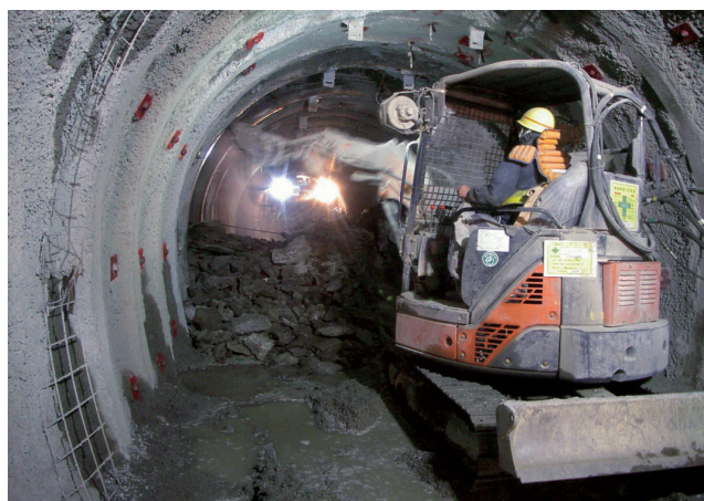
深度350 m調査坑道における換気立坑と東立坑間の貫通
